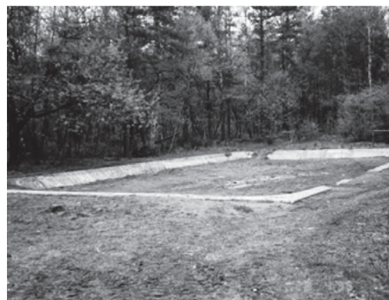
Le bassin d'extinction des incendies.
