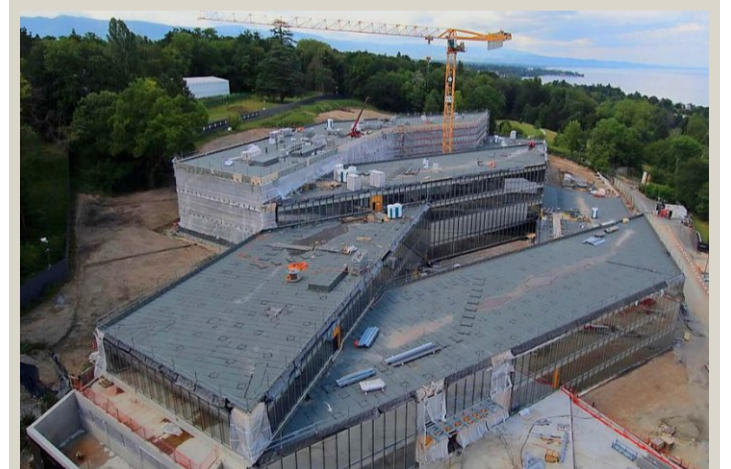
Le chantier de transformation du bâtiment onusien avait été interrompu par le Covid-19. STRATEGIC HERITAGE PLAN
