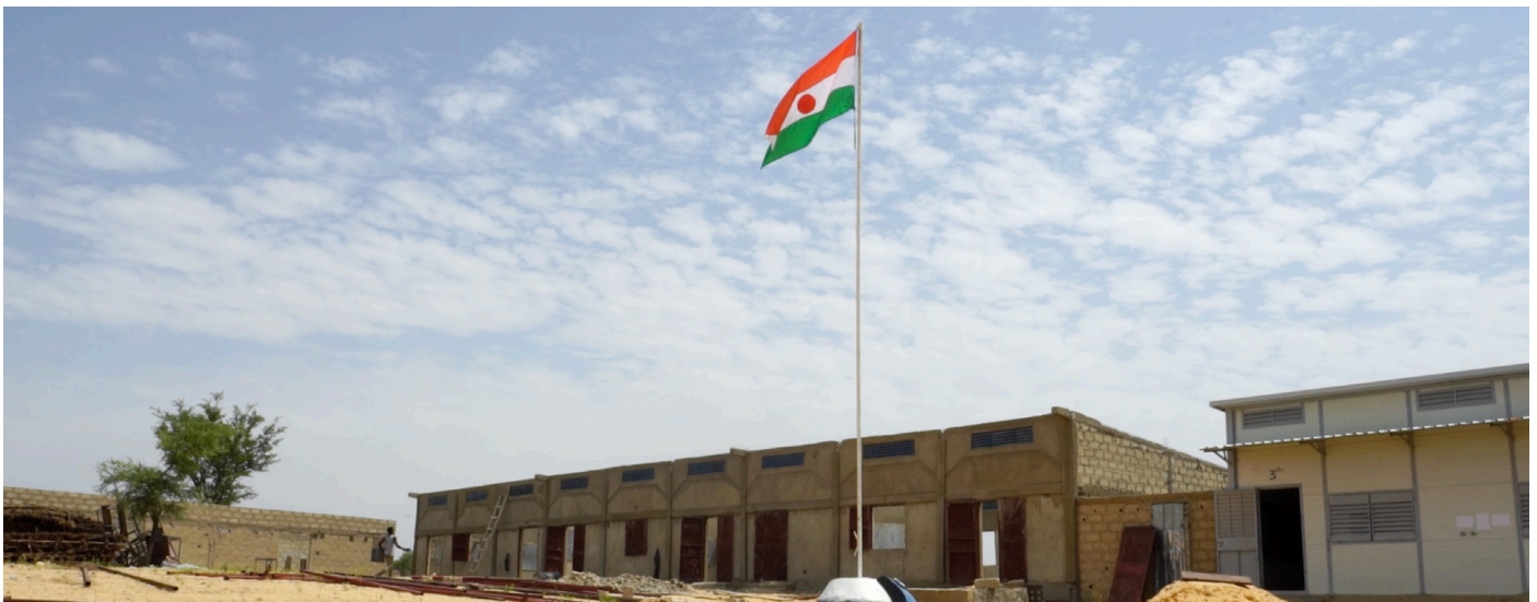
Des salles de classes en construction dans le cadre du FCSE / Région de Maradi
