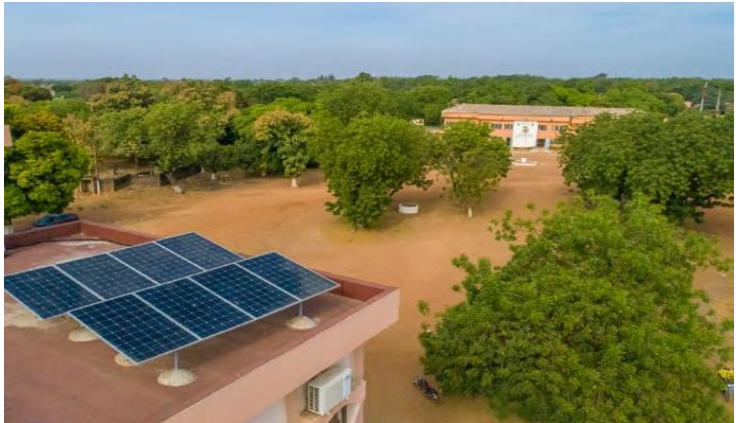
Panneaux solaires installés à la mairie de Kandi par le programme d'Appui au Secteur de la Gouvernance Locale (ASGoL) auquel a succédé le programme Appui à la Gouvernance locale et au Renforcement de l'Attractivité territoriale (AGORA)._ © Coop. Suisse Bénin.
