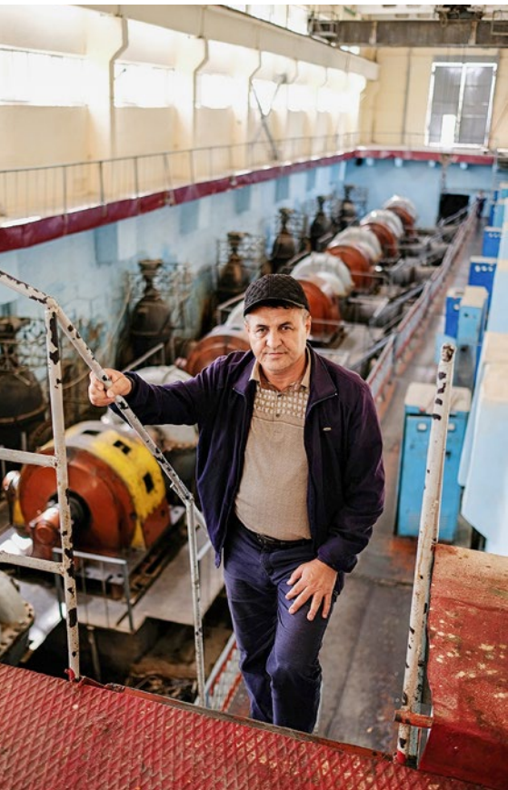
Asror Sobirov est le directeur de la station de pompage ouzbèke de Yondar depuis vingt-trois ans. Celle-ci a été construite en 1982 et devrait être rénovée de toute urgence.
