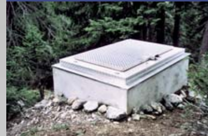
Caisson contenant les appareils de mesure
