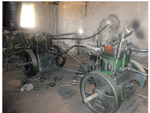
Un moulin servant de générateur pour la fourniture d'énergie électrique pour la radio
