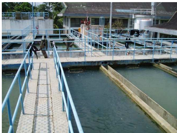
Depuis sa réhabilitation, l'installation de traitement de l'eau potable de Lambaro (Banda Aceh) alimente la population locale en eau potable de qualité. © DDC
